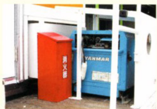
消化器・発電機
